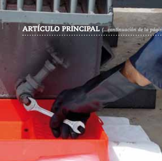
Apertura de la válvula de vaciado
