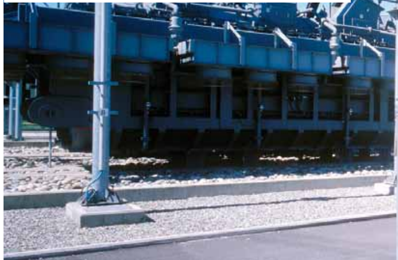
Transformador de potencia
