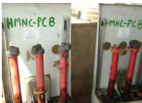
Disyuntores con aceite mineral no contaminado
