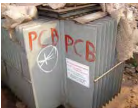
Transformador eléctrico con PCB (nivel de PCB > 500 ppm)
