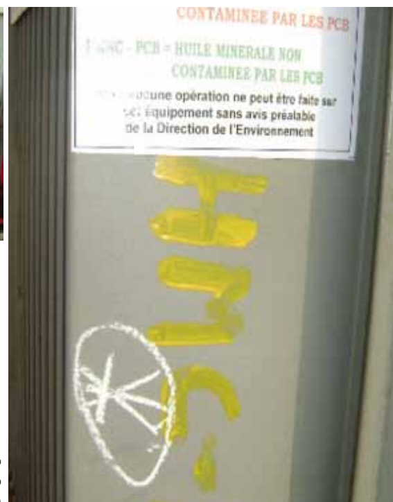
Transformador eléctrico clasificado como contaminado (nivel de PCB entre 51 y 499 ppm)
