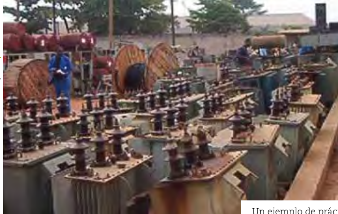
Un ejemplo de práctica deficiente de almacenamiento
