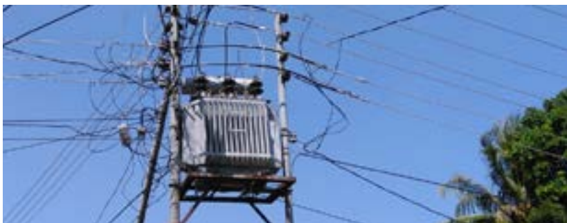
Figura 18. Equipo sospechoso de contener PCB en una línea de 2.4 kV en la ciudad de Retalhuleu
