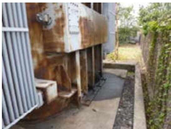
Figura 60. Ejemplo de un equipo clasificado como “Sospechoso de PCB” con derrame incluido en el listado de sitios posiblemente contaminados.
